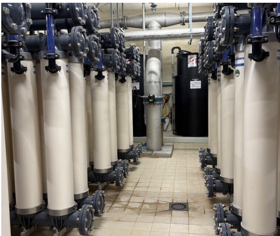
Dans la station de traitement des Varras, leau est filtrée pour devenir potable. ©Mathilde Carnet
